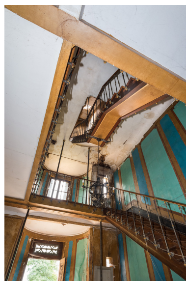
Escalier d'accès à la tourelle (extension nord fin 19e siècle). Phot. Pierre-Marie Barbe-Richaud
