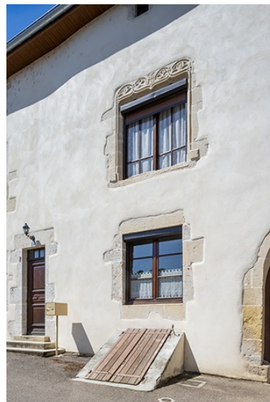
Détail de la façade, de l'entrée du cellier et des baies du n° 37. Phot. Jérôme Mongreville IVR43_20217000363NUC4A
