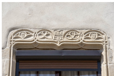
Détail du premier étage du n° 37 : linteau sculpté de la baie. Phot. Jérôme Mongreville IVR43_20217000364NUC4A
