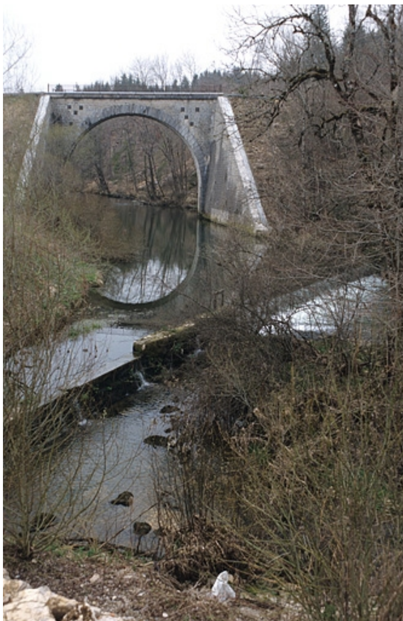
Pont sur l'Angillon : vue d'ensemble, depuis l'ouest (aval, rive droite). Au premier plan, le barrage de l'ancienne usine de menuiserie de la société des Constructions métalliques Fillod.
