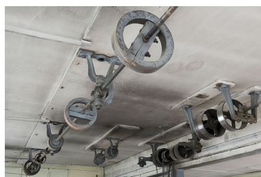
Intérieur de l'atelier. Système de transmissions. Phot. Jérôme Mongreville IVR43_20112501421NUC4A
