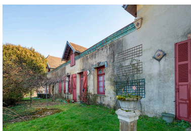
Elévation des façades ouest. Vue de trois quarts droite. Phot. Jérôme Mongreville IVR43_20243900520NUC4A
