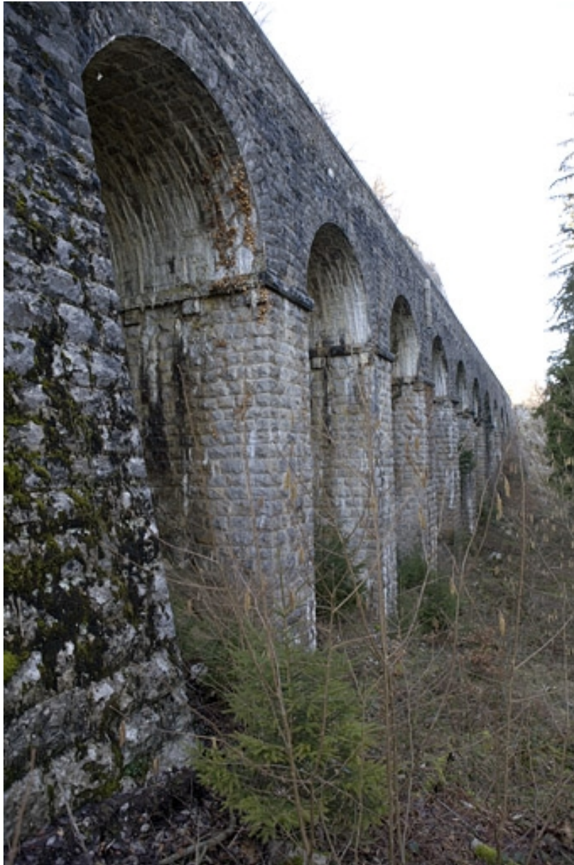
Deuxième mur à arcades : vue en enfilade, depuis le côté La Cluse. Mur débutant au PK 020.411.
