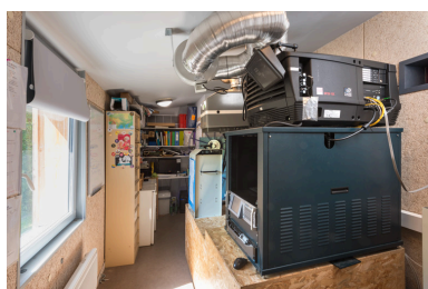
Cabine de projection. Au premier plan le projecteur numérique Barco DP2K-12C. Phot. Pierre-Marie Barbe-Richaud IVR26_20257100901NUC4A
