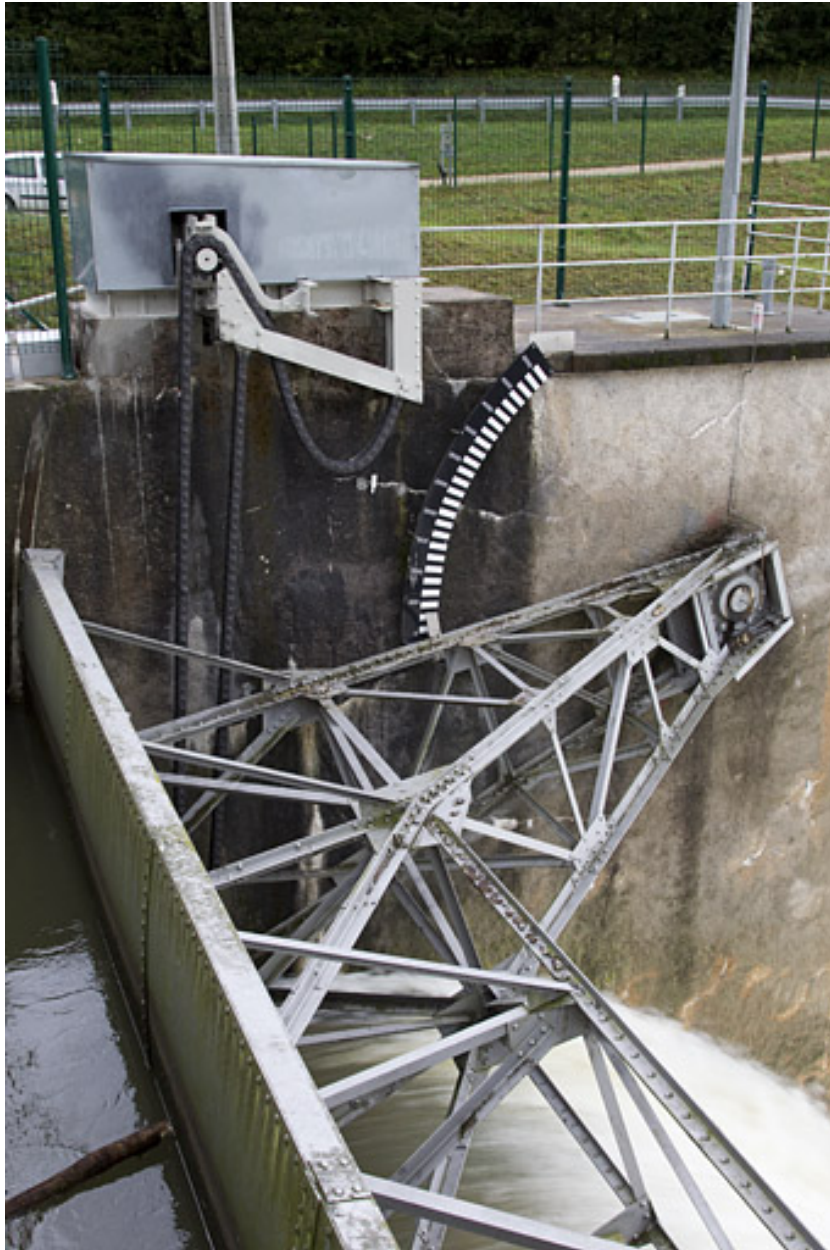
Barrage : système d'ouverture d'une vanne secteur (vanne évacuateur de crue).
