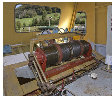
Prise d'eau : treuil actionnant le bras du dégrilleur. Phot. Yves Sancey IVR43_20122501977NUC2A
