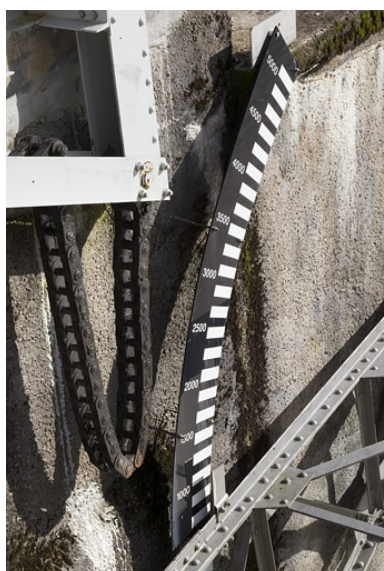
Barrage : repère mesurant l'ouverture d'une vanne secteur. Phot. Yves Sancey IVR43_20122501983NUC2A
