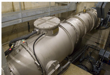
Centrale : nouveau groupe de restitution. Phot. Yves Sancey IVR43_20122501989NUC2A
