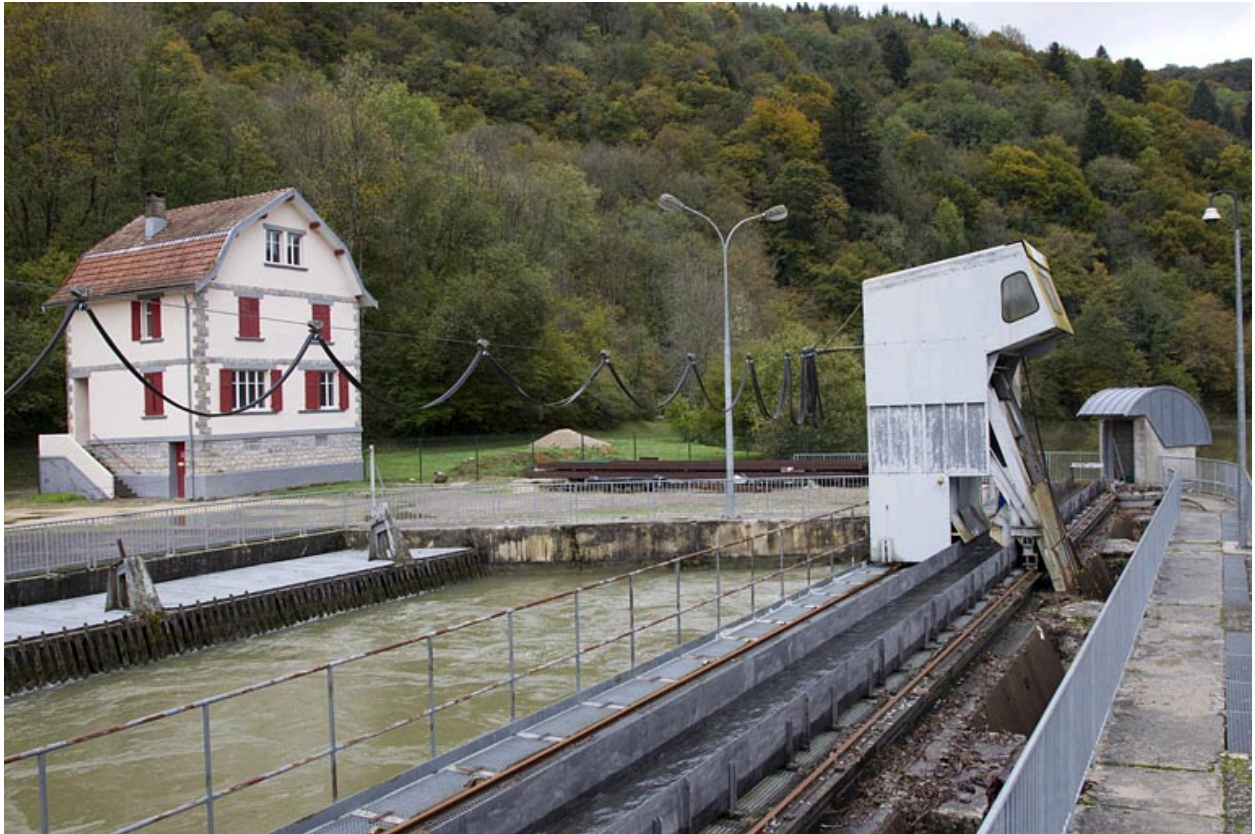
Prise d'eau : vue d'ensemble du dégrilleur.
