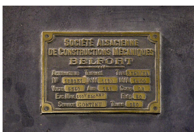
Centrale : plaque signalétique de l'alternateur. Phot. Yves Sancey IVR43_20122501987NUC2A
