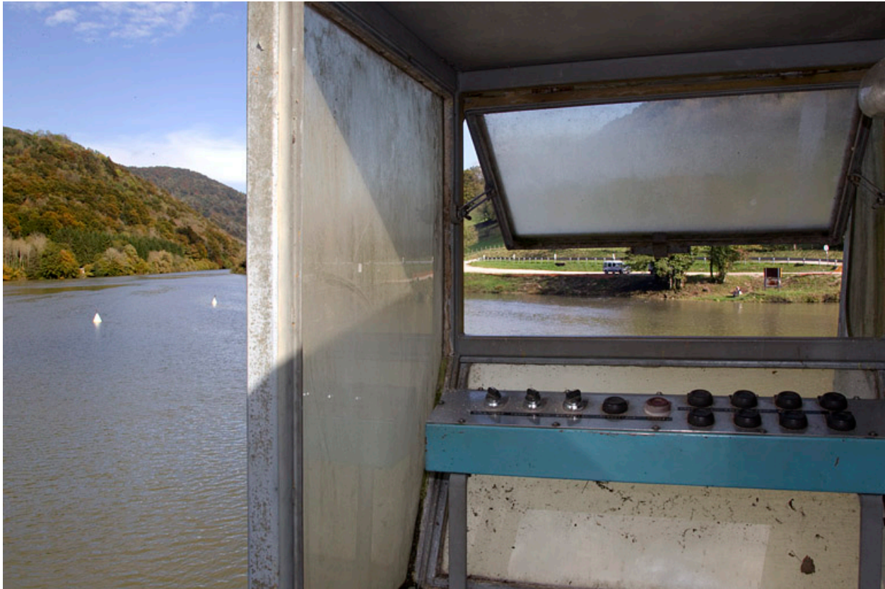
Prise d'eau : poste de commande du dégrilleur.
