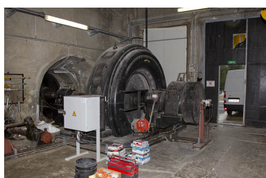
Centrale : intérieur de la salle des machines et groupe de hautes eaux. Phot. Yves Sancey IVR43_20122501985NUC2A
