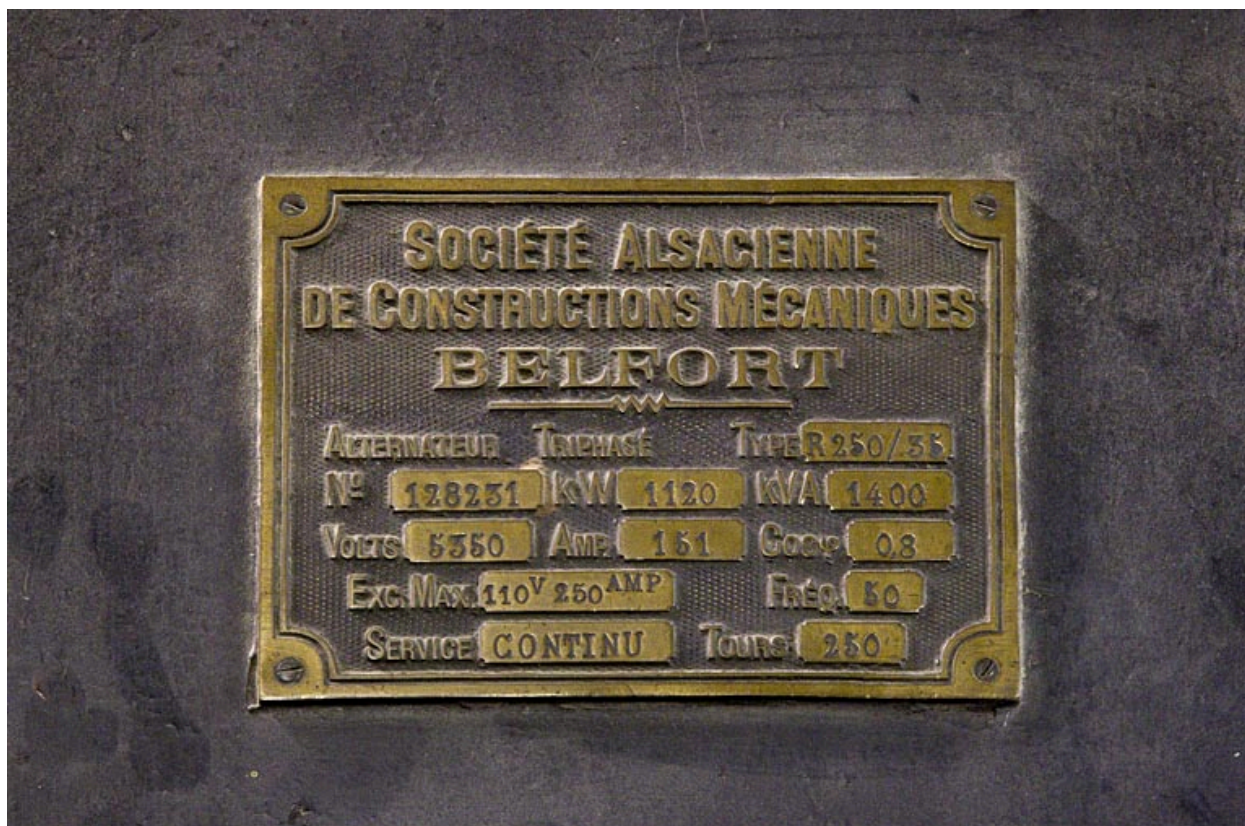
Centrale : plaque signalétique de l'alternateur.
