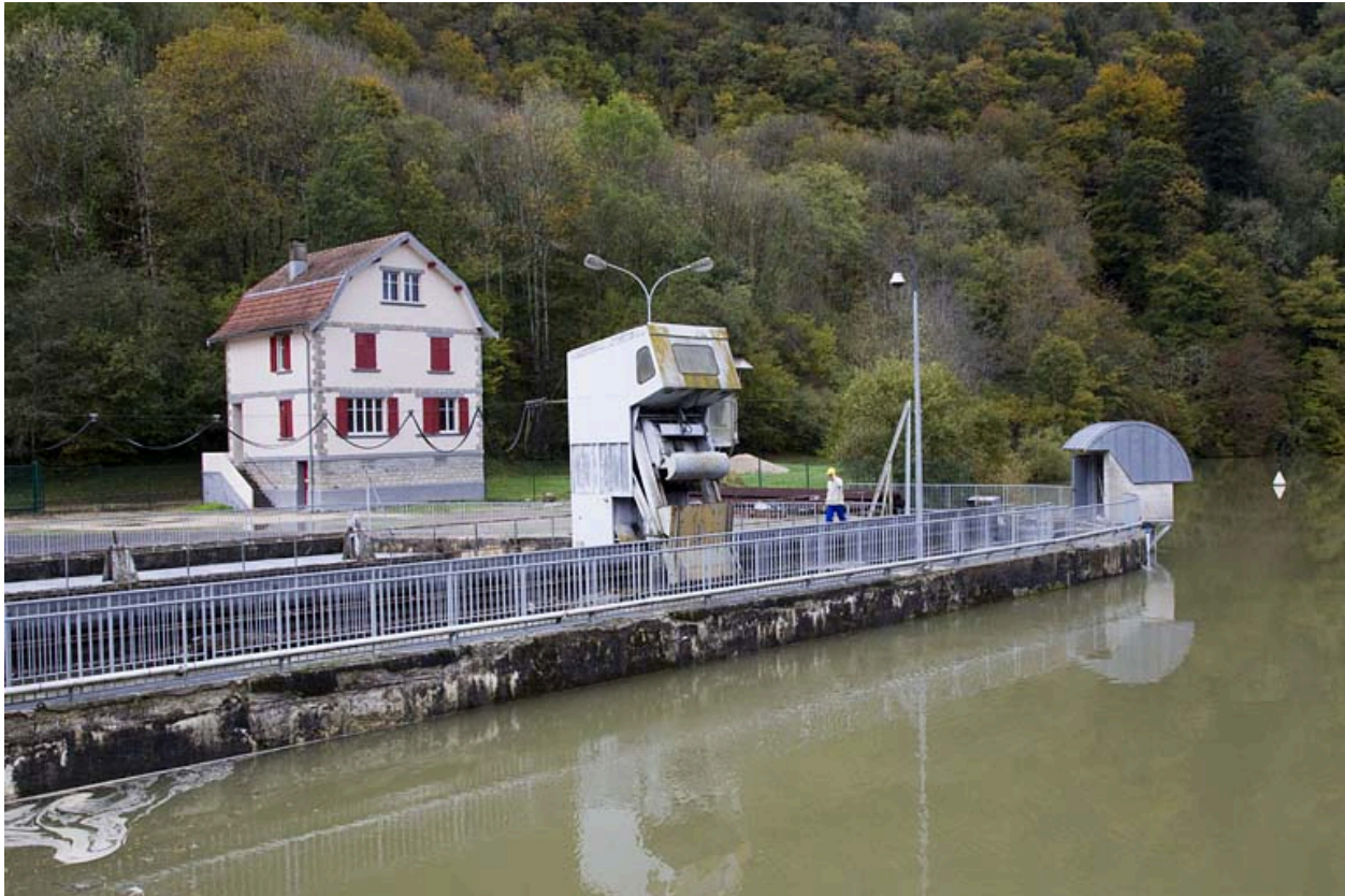
Prise d'eau : grilles de protection du bassin et dégrilleur.
