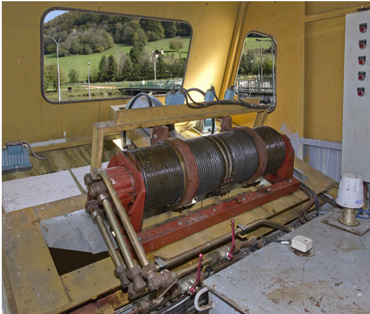
Prise d'eau : treuil actionnant le bras du dégrilleur.
