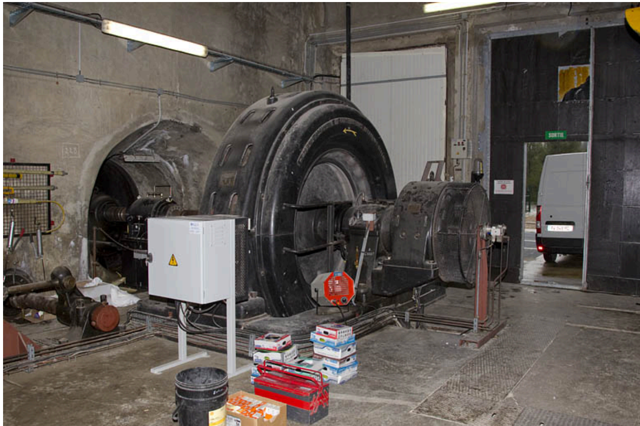
Centrale : intérieur de la salle des machines et groupe de hautes eaux.
