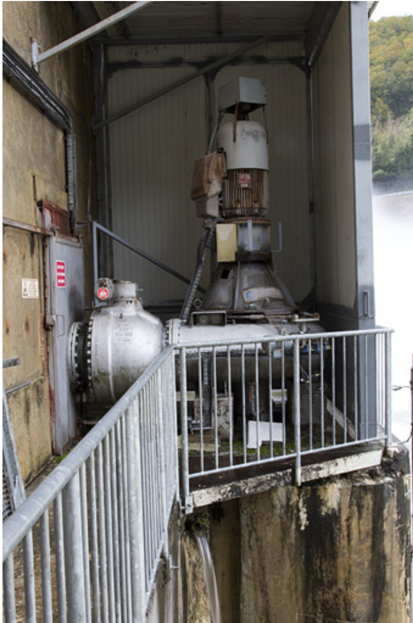
Centrale : ancien groupe de restitution.
