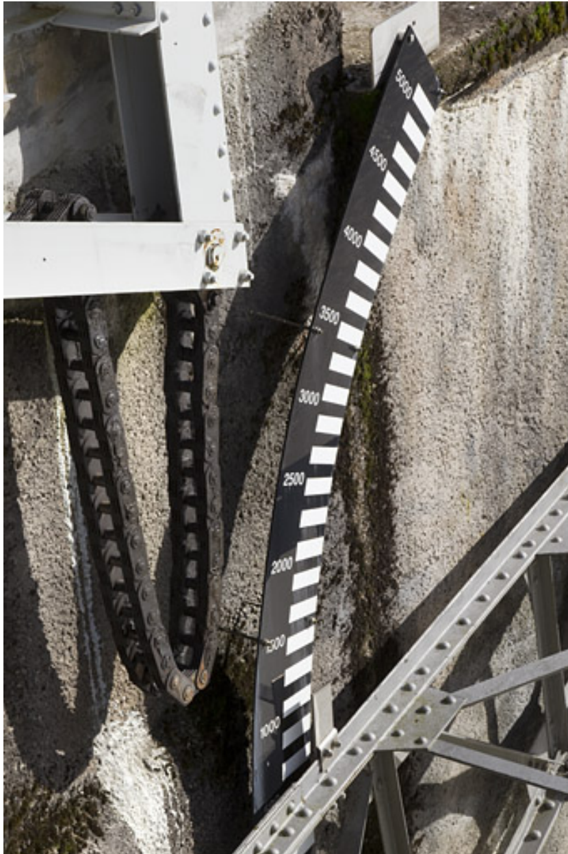
Barrage : repère mesurant l'ouverture d'une vanne secteur.
