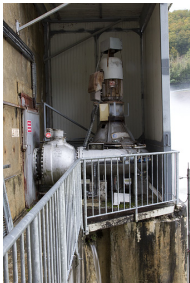
Centrale : ancien groupe de restitution. Phot. Yves Sancey IVR43_20122501988NUC2A
