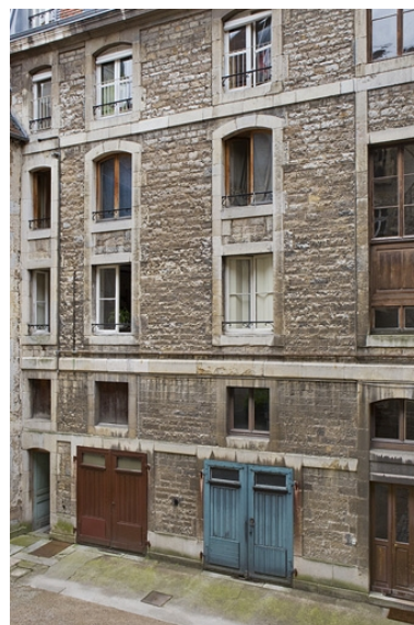
Façade postérieure sur cour : détail de l'aile droite. Phot. Yves Sancey IVR43_20102500851NUC2A
