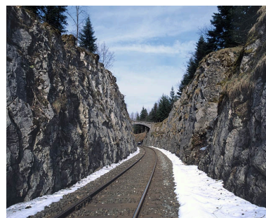
Vue d'ensemble du pont et de la tranchée, depuis la voie (côté Andelot-en-Montagne). Phot. Yves Sancey IVR43_20053900118XA
