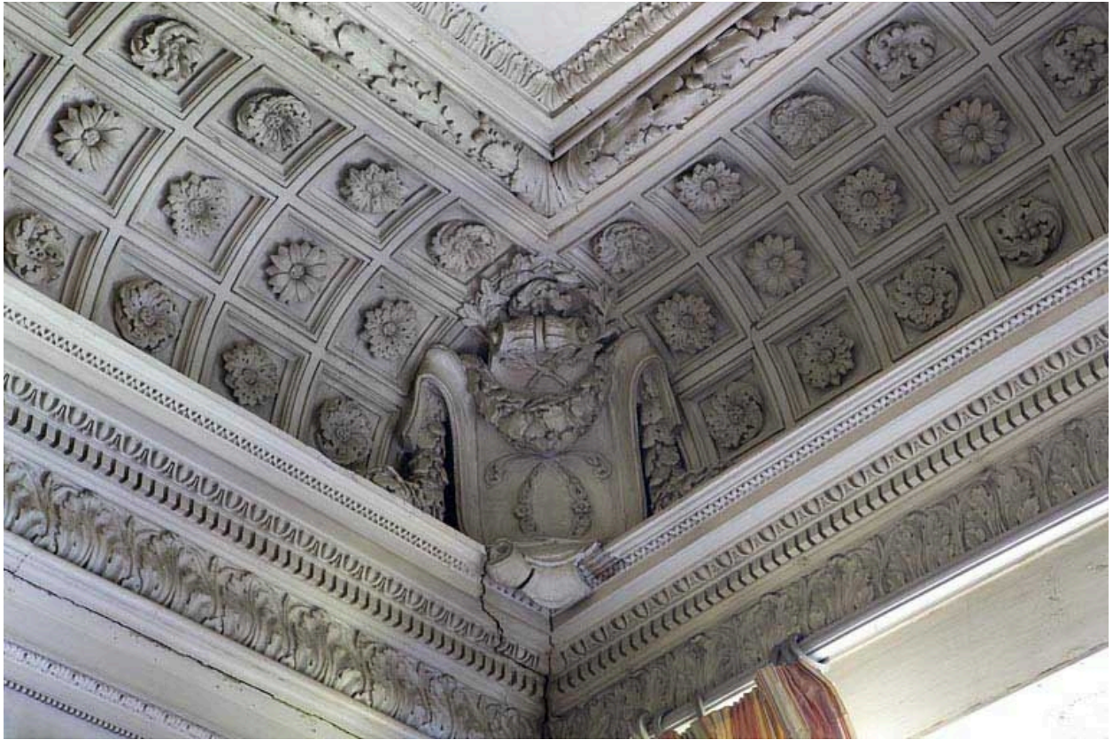
Hôtel en fond de cour, grand salon : détail d'un angle du plafond portant le monogramme C.
