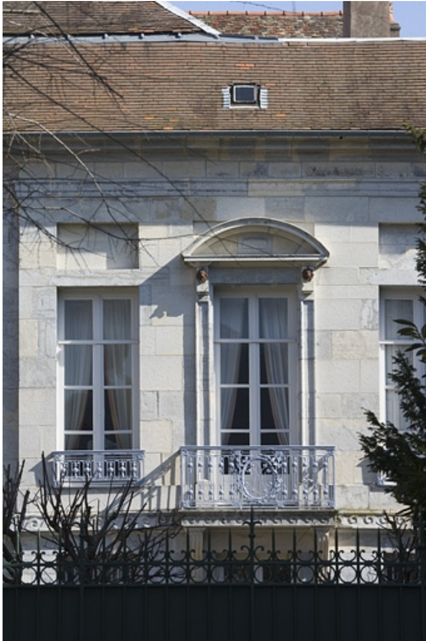
Hôtel en fond de cour : détail de la fenêtre centrale, premier étage sur jardin.
