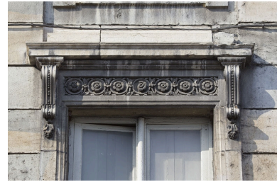
Façade antérieure, fenêtre du premier étage : détail du linteau décoré de fleurons. Phot. Yves Sancey IVR43_20102500991NUC2A
