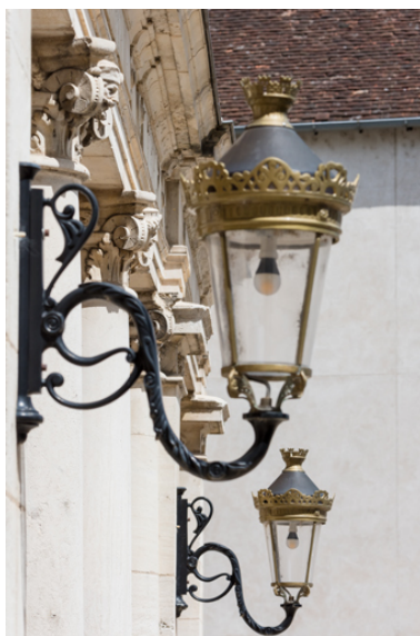
Porche : luminaires d'applique extérieurs. Phot. Pierre-Marie Barbe-Richaud IVR26_20235800261NUC4A
