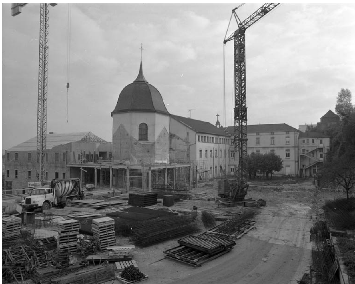
Chapelle depuis la cour donnant rue de l'Arsenal pendant les travaux de démolition de l'année 1989.
