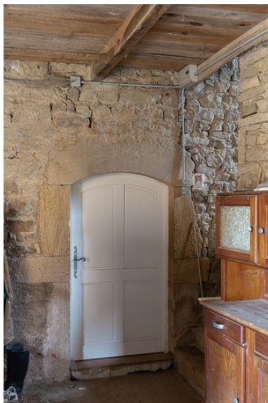
Porte d'entrée de la maison, donnant sur l'escalier. Avant la construction du cuvage, cette ouverture était vraisemblablement l'entrée originelle de l'habitation.
