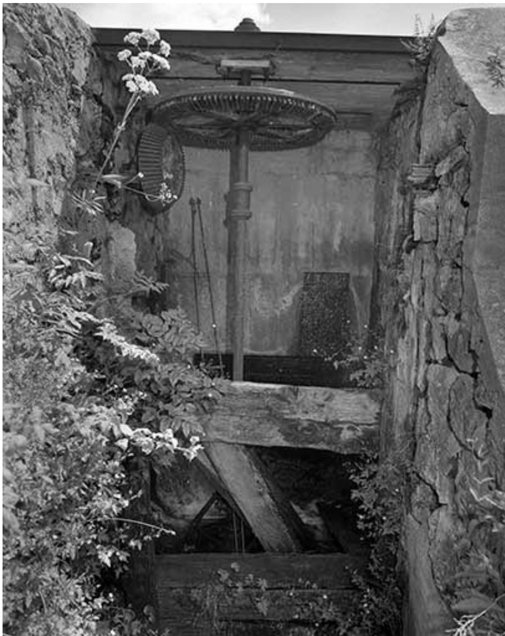
Système de roues hydrauliques, vue générale.
