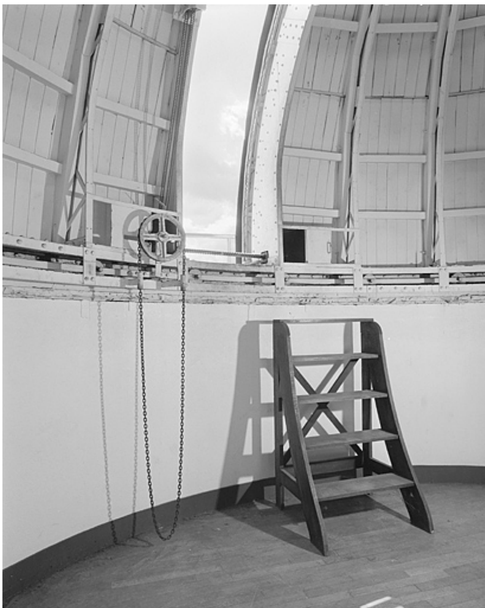
Vue d'ensemble du système d'ouverture du dôme.
