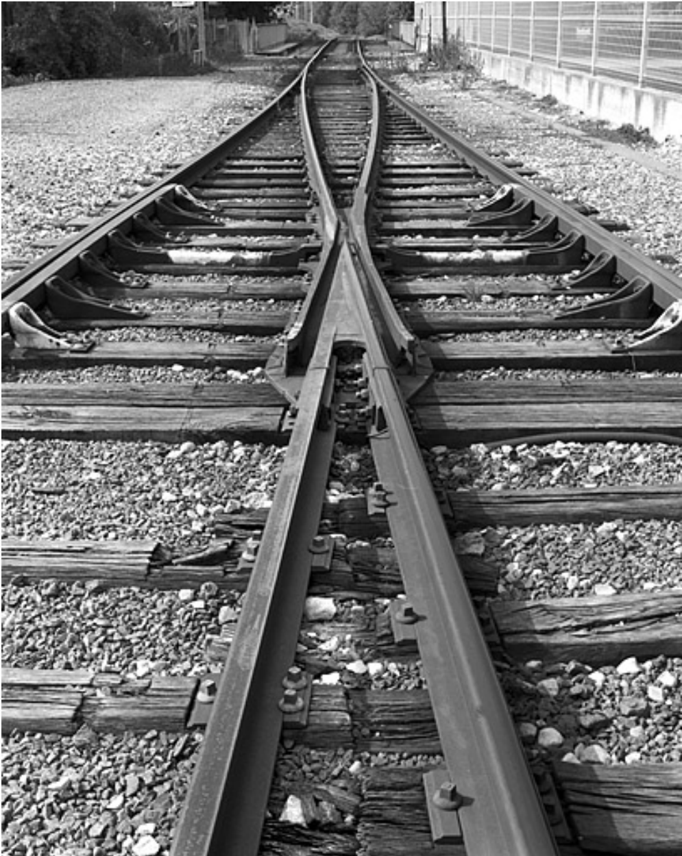
Appareil de voie (" aiguillage ") à l'extrémité de la gare, côté La Cluse (sud-ouest).
