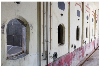
Intérieur de l'entrepôt : enfilade des cuves du premier niveau. Phot. Marc Loukachine IVR43_20112502365NUC4A
