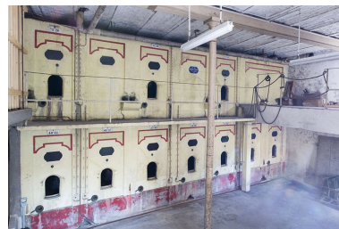
Intérieur de l'entrepôt : vue d'ensemble des cuves. Phot. Marc Loukachine IVR43_20112502364NUC4A
