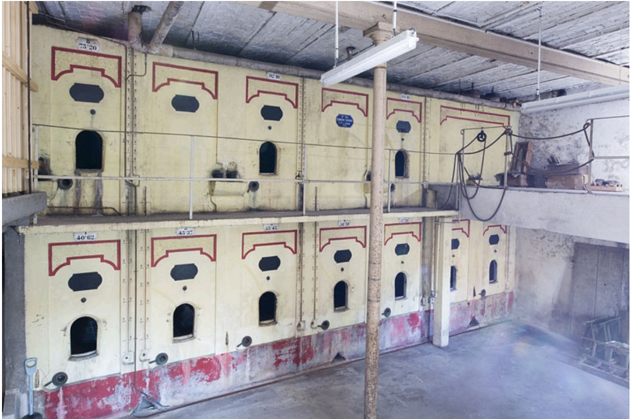
Intérieur de l'entrepôt : vue d'ensemble des cuves.
