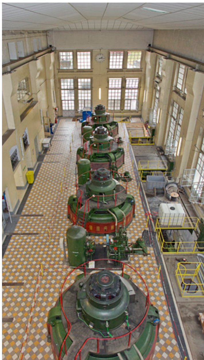
Centrale hydroélectrique : vue plongeante sur la salle des machines.
