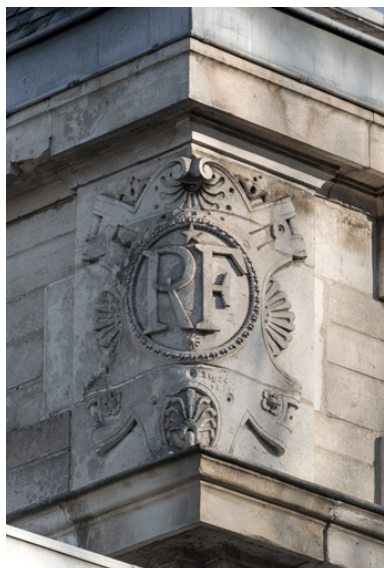
Façade latérale droite, attique : inscription RF sur l'angle gauche. Phot. Pierre-Marie Barbe-Richaud IVR26_20238900200NUC4A
