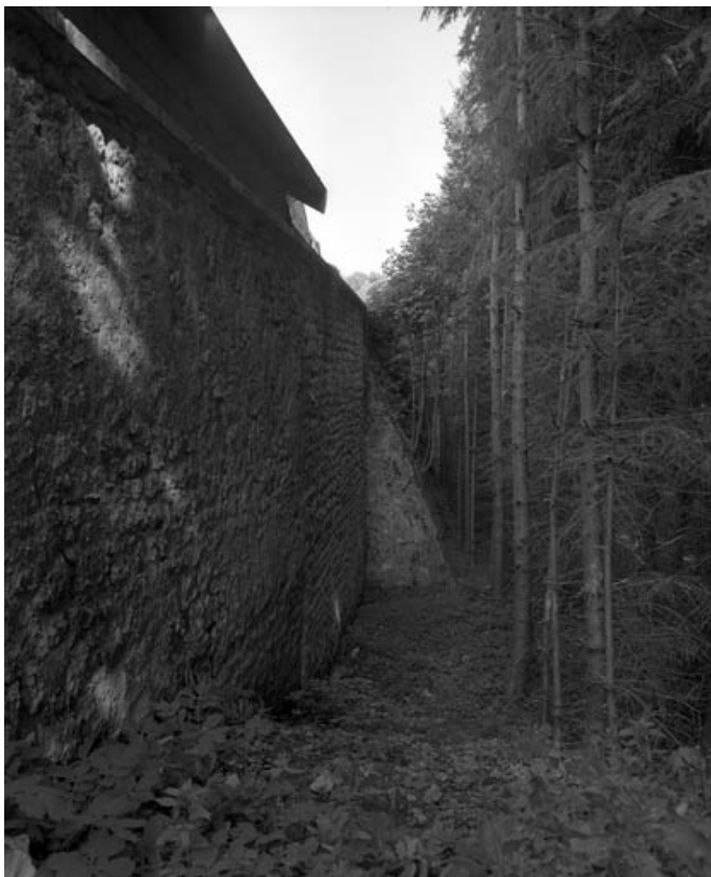
Restes de rempart du bastion de la Visitation (derrière la rue Cécile) : de trois quarts gauche.
