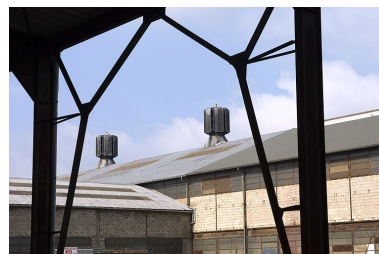
Atelier de fabrication. Cheminées d'extraction. Phot. Jérôme Mongreville IVR43_20067000135NUCA
