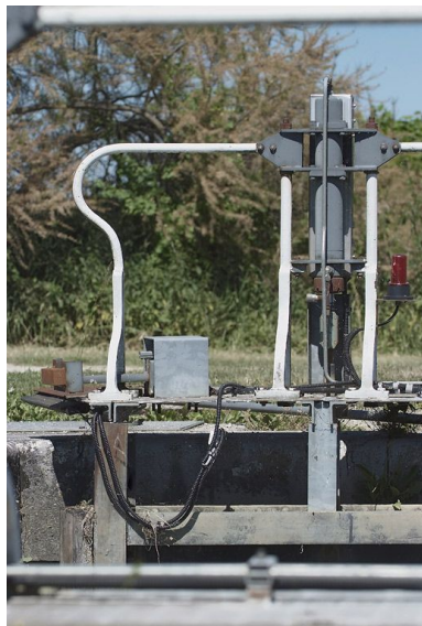
Détail du système d'automatisation des portes. Phot. Thierry Kuntz IVR26_20112103076NUC2A
