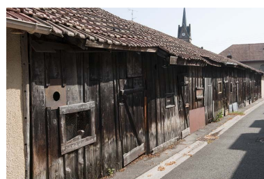
Bûchers rue des Cités. Phot. Jérôme Mongreville IVR43_20112502242NUC4A
