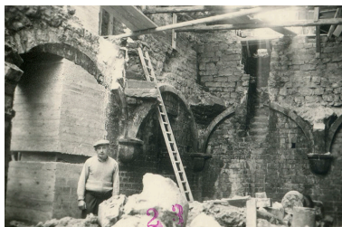
Vue de la cave pendant les travaux de démolition, s.d. [1958]. Phot. auteur inconnu IVR43_20243900098NUC4A
