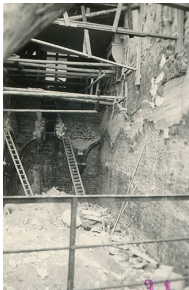
Vue de la cave pendant les travaux de démolition, s.d. [1958]. Phot. auteur inconnu IVR43_20243900097NUC4A
