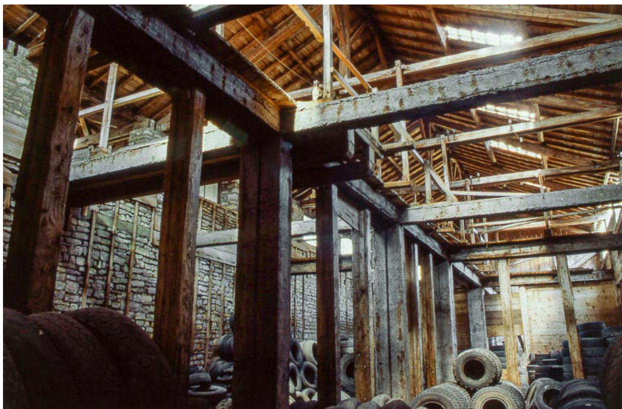
Intérieur d'un magasin industriel.
