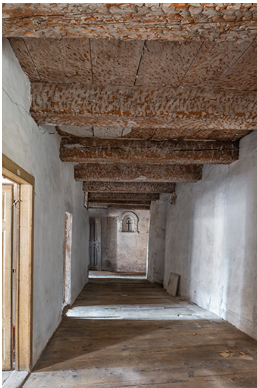
Second étage du bâtiment nord. Le couloir distribuant les cellules des moniales.
