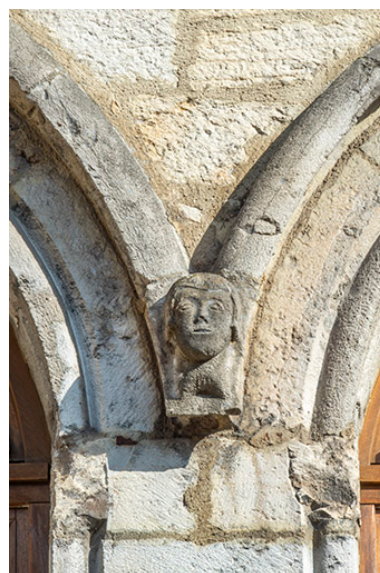
Façade antérieure. Tête sculptée à la retombée des arcs des deux premières baies. Phot. Jérôme Mongreville IVR43_20243900584NUC4A
