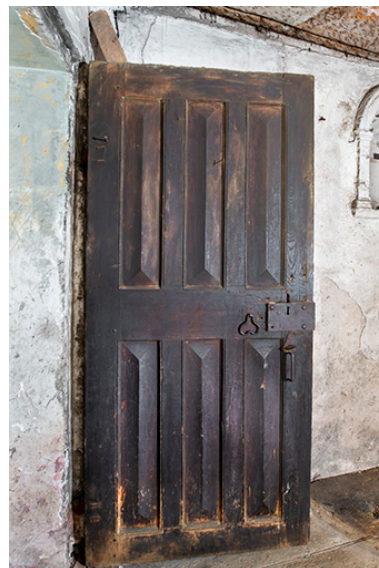
Porte de communication entre la tour polygonale et l'aile nord. Phot. Jérôme Mongreville IVR43_20233900389NUC4A
