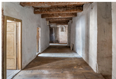
Second étage du bâtiment nord. Le couloir distribuant les cellules des moniales. Phot. Jérôme Mongreville IVR43_20233900383NUC4A
