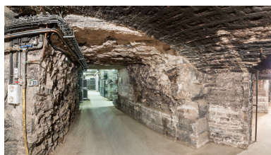
Caves sous la tour nord-est : le passage creusé dans l'ancien rempart. Phot. Pierre-Marie Barbe-Richaud IVR26_20142101386NUC4AQ
