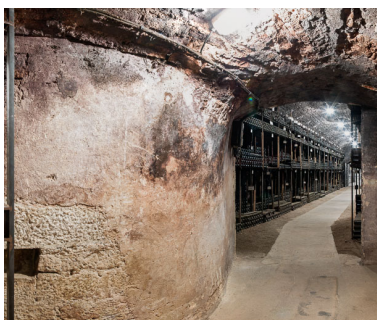
Cave de vieillissement, le long de l'ancien rempart (1er sous-sol) : au premier plan, fondations de la tour nord-ouest. Phot. Pierre-Marie Barbe-Richaud IVR26_20142101394NUC4AQ
