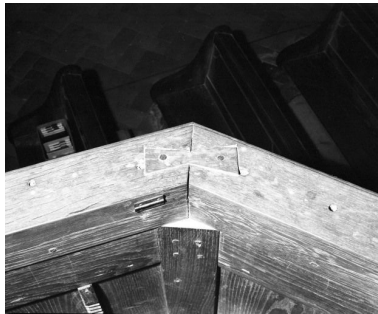
Détail de l'assemblage de l'appui rapporté de la cuve Phot. Jean-Luc Duthu IVR26_19852101024X
