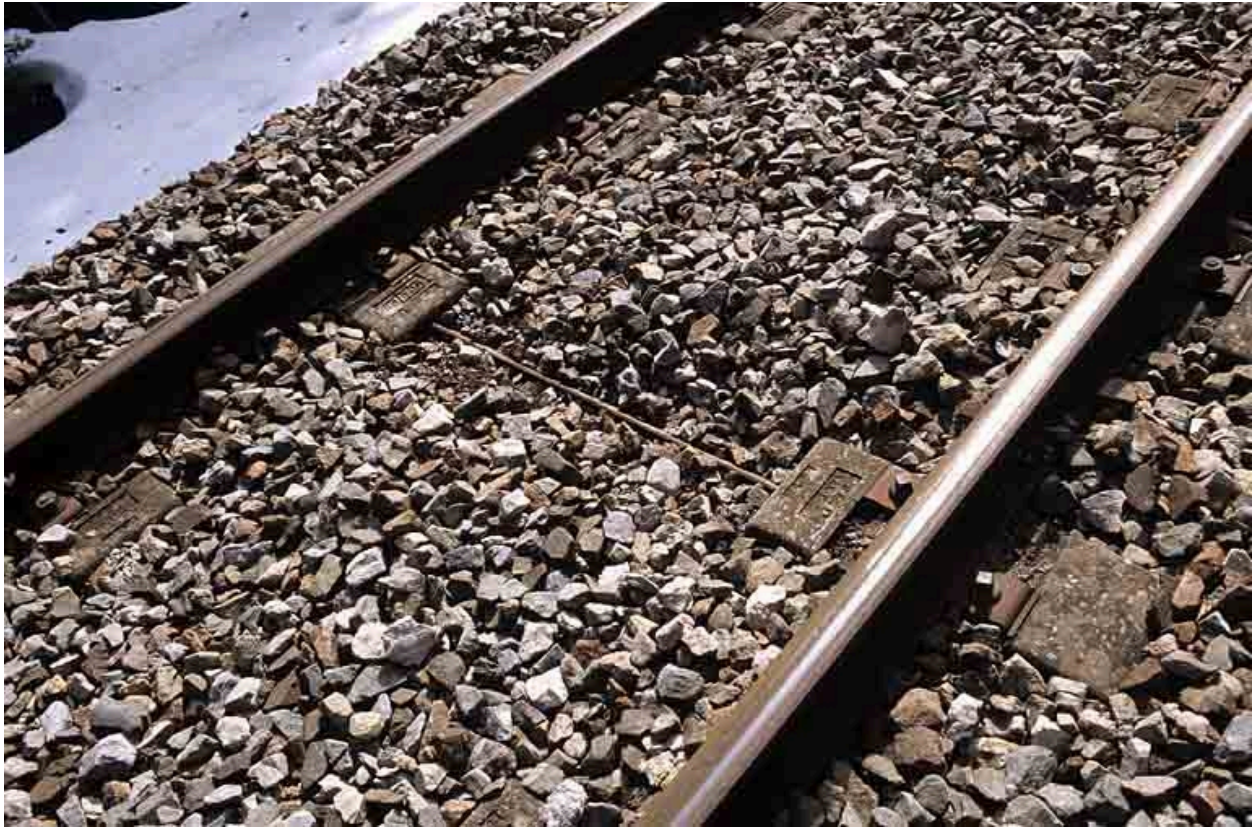
Vue plongeante sur une traverse Sateba, à proximité du pont sur la R.D. 18 (PK 045.208), commune de Morbier.
