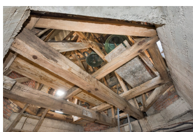
Enrayure de charpente du clocher. Vue en contre-plongée. Phot. Pierre-Marie Barbe-Richaud IVR26_20238901171NUC4A
