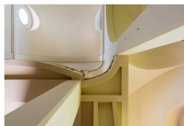
Couvrement de l'église à la jonction de la tribune, du vaisseau central et du bas-côté. Vue en contre-plongée. Phot. Pierre-Marie Barbe-Richaud IVR26_20238901132NUC4A
