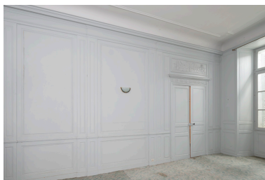
Aile nord. Boiseries d'une pièce du premier étage. Phot. Jérôme Mongreville IVR43_20223901310NUC4A
