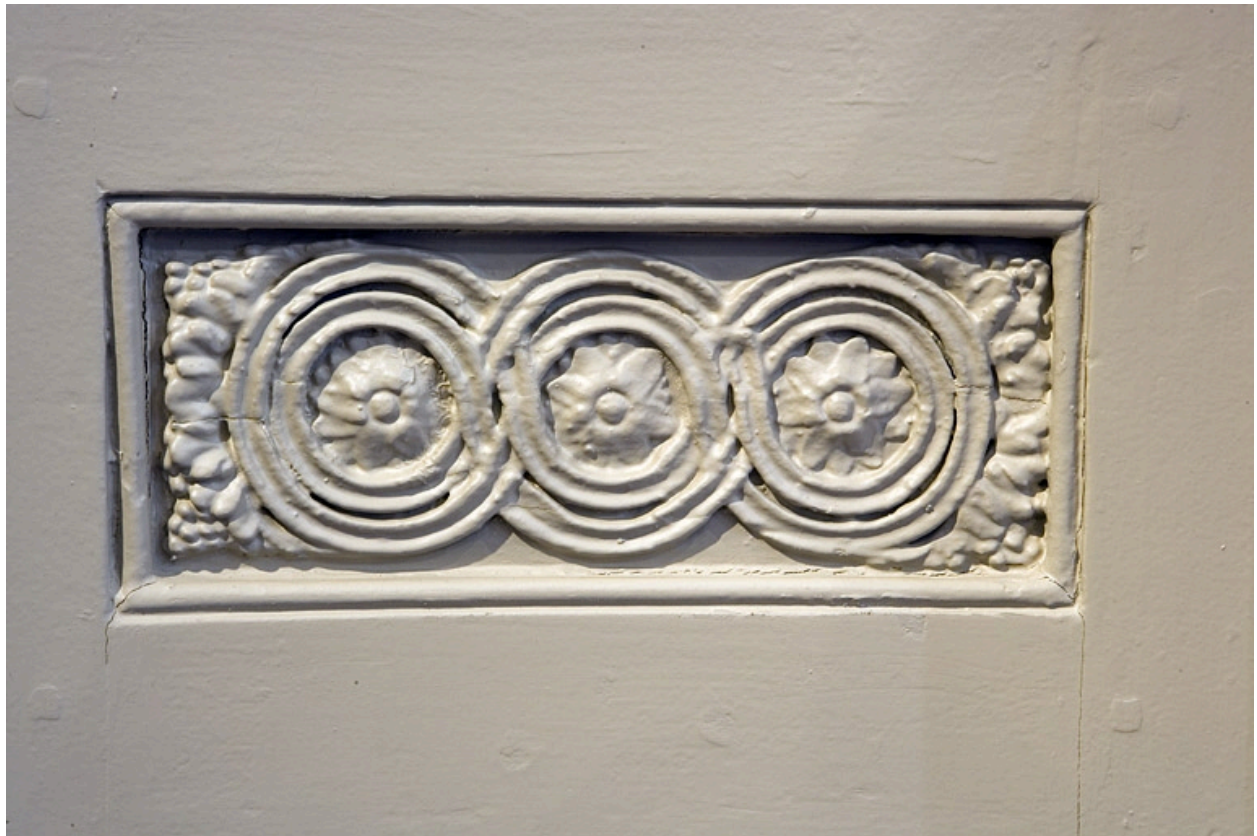
Détail d'un des décors de rosaces encadrant la cheminée située au premier étage.
