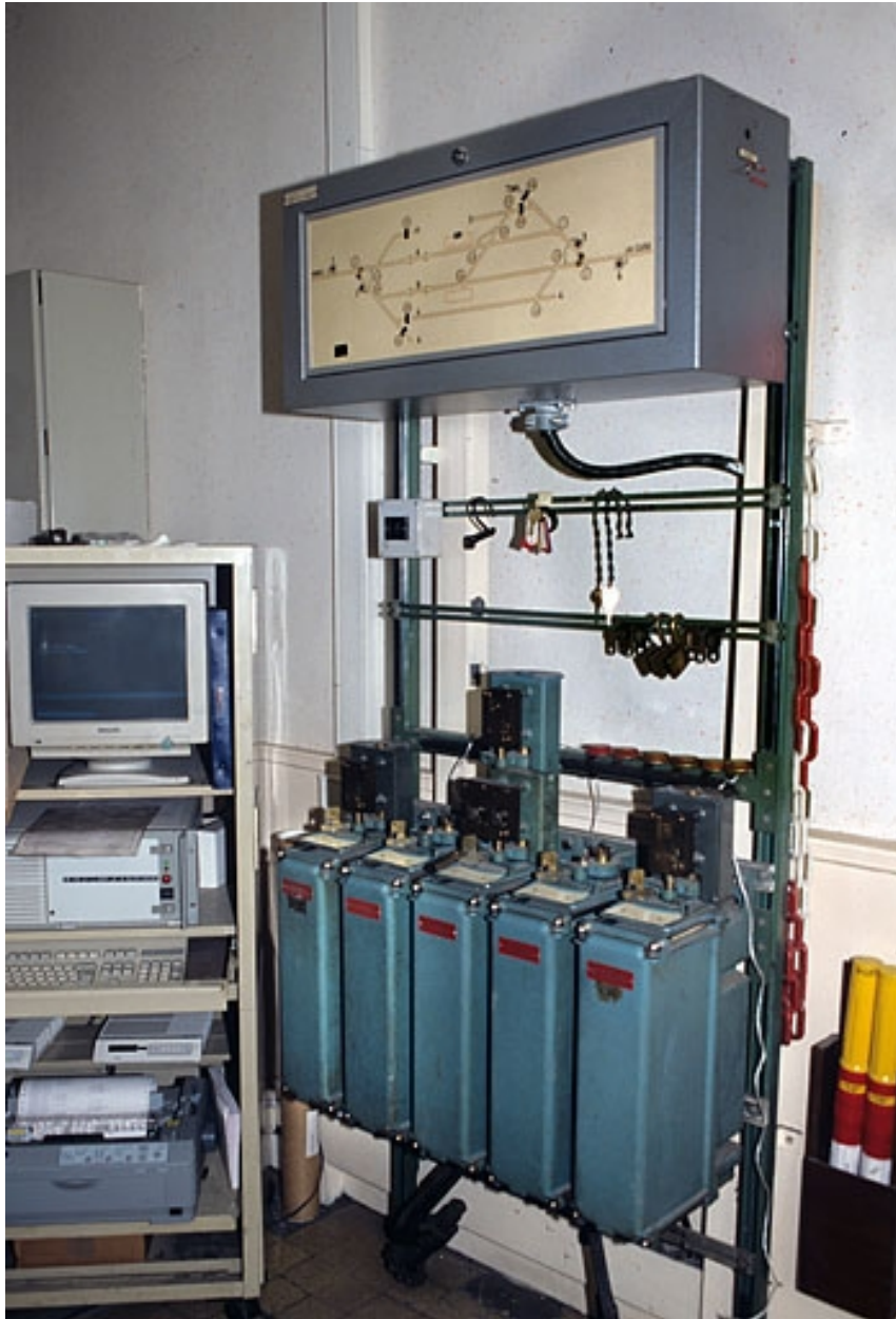
Vue d'ensemble, de trois quarts droite. Le tableau de contrôle optique surmonte les commutateurs. A gauche, ordinateur du système CAPI (cantonnement assisté par informatique).
