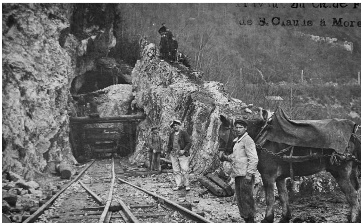
Travaux du Ch. de Fer de S. Claude à Morez [percement du tunnel du Pain de Sucre, avec personnages et chantier côté La Cluse], 1909-1910.
