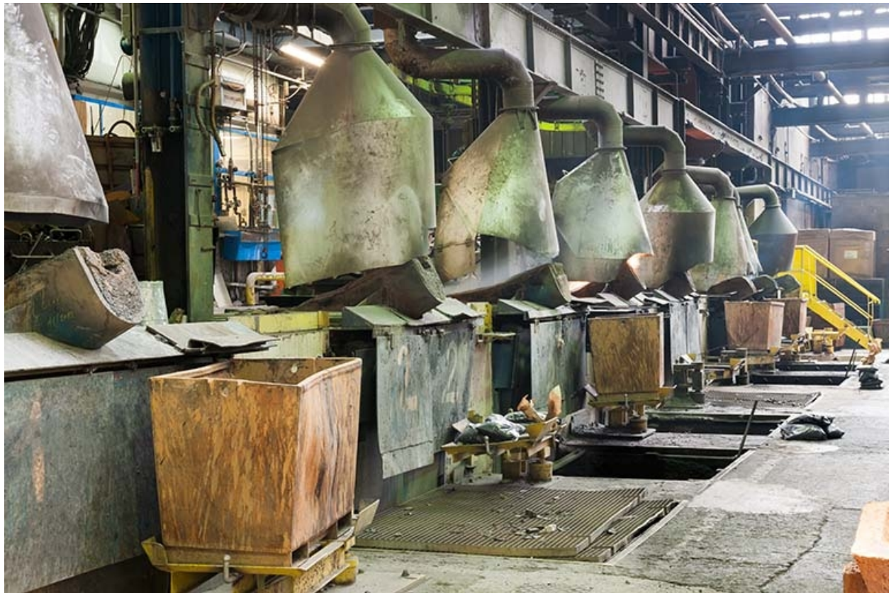
Batterie de fours à induction (1).
