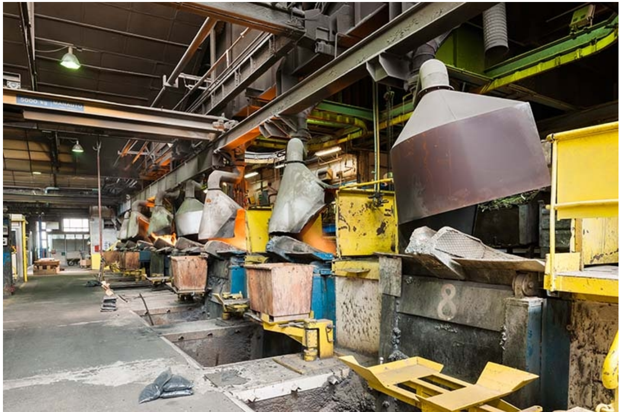
Batterie de fours à induction (2).
