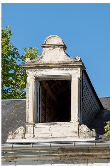
Façade de la maison de Marien dit Georges Bigouret, lucarne. Phot. Pierre-Marie Barbe-Richaud IVR26_20205800499NUC4A
