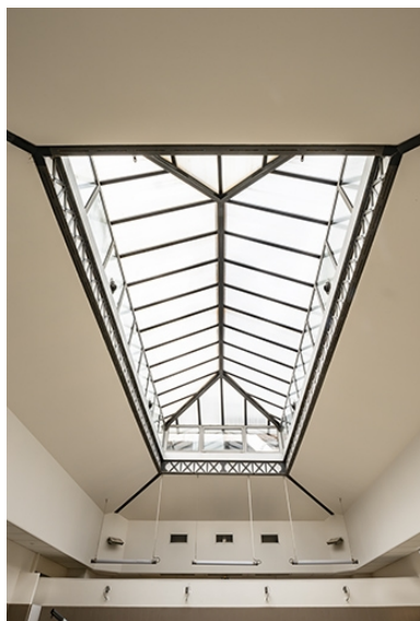
Bassin, à l'emplacement de l'ancienne piscine des Hommes). Phot. Jérôme Mongreville IVR43_20223900035NUC4A
