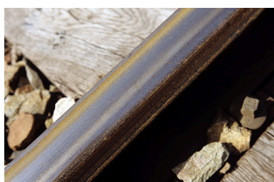
Usure d'un rail, sur le viaduc de Morbier. Phot. Yves Sancey IVR43_20053900325ZA
