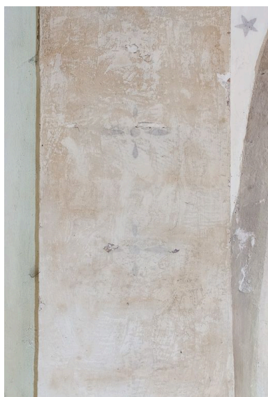
Détail des traces de peintures murales du choeur. Phot. Pierre-Marie Barbe-Richaud IVR26_20162100203NUC2A
