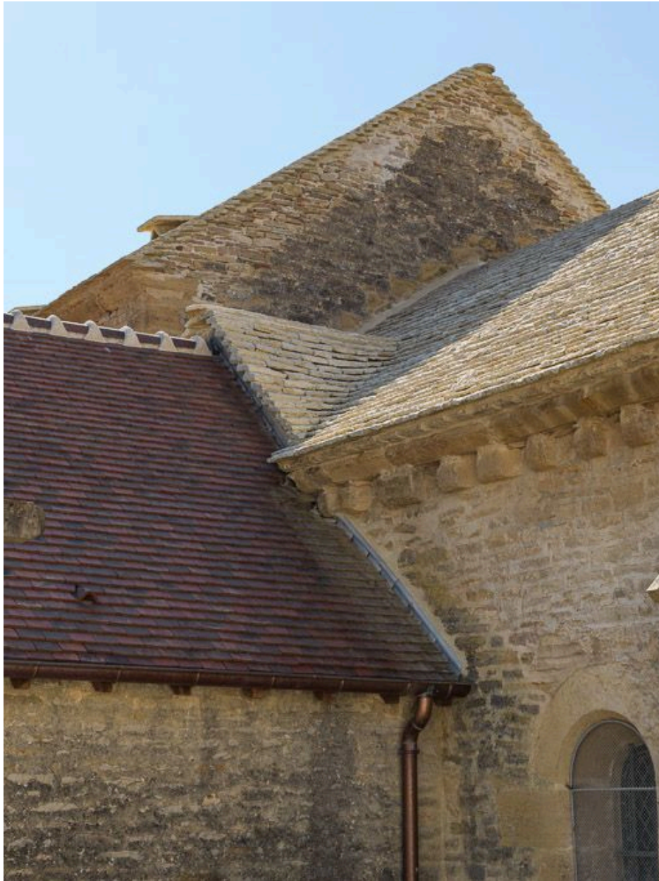
Détail des toitures du chœur, de la chapelle nord-est et de la nef.
