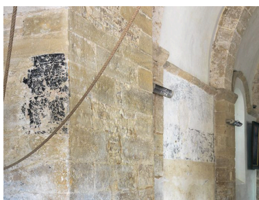
Détail des traces de litre funéraire dans la nef. Phot. Pierre-Marie Barbe-Richaud IVR26_20162100191NUC2A
