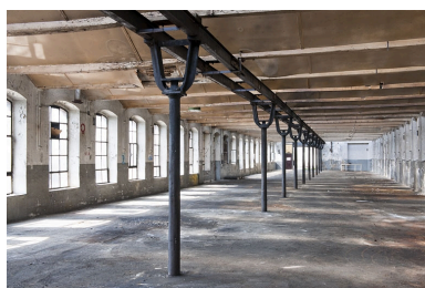
Usine Constant Peugeot, dite Sous-Roches, à Valentigney. Intérieur d'un atelier. Phot. Jérôme Mongreville IVR43_20112501599NUC4A
