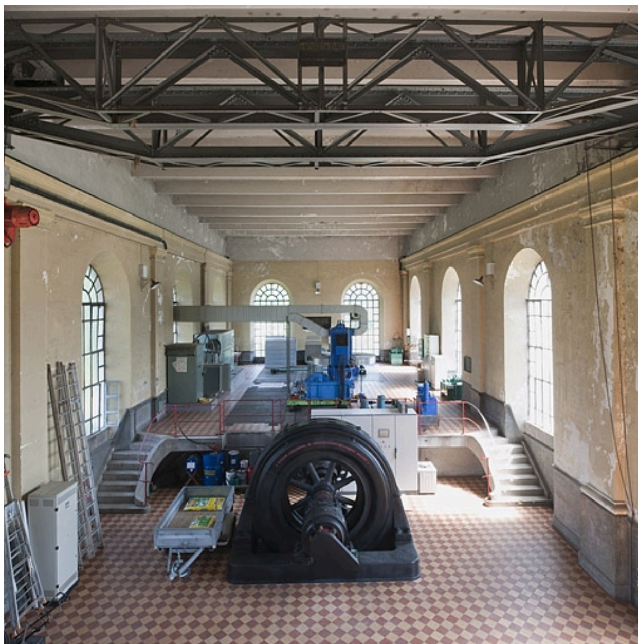
Salle de la centrale hydroélectrique de Mathay.
