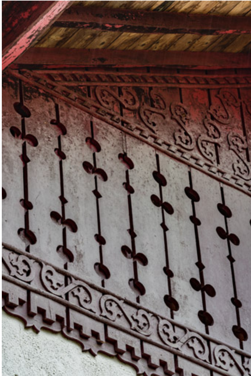
Placage de planches en bois ajourées et sculptées du pignon sous la saillie de rive.
