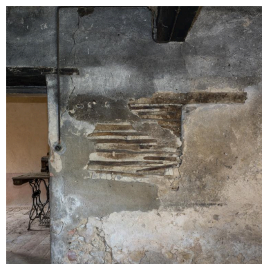
Détail de la cloison de la cuisine (ancienne chambre) de la maison Mommessin Phot. Pierre-Marie Barbe-Richaud IVR26_20187100171NUC2A
