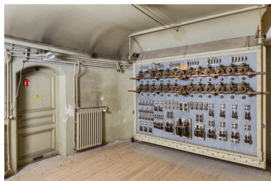
Sous-sol : salle du jeu d'orgue. Le jeu d'orgue. Phot. Pierre-Marie Barbe-Richaud IVR26_20257100335NUC4A
