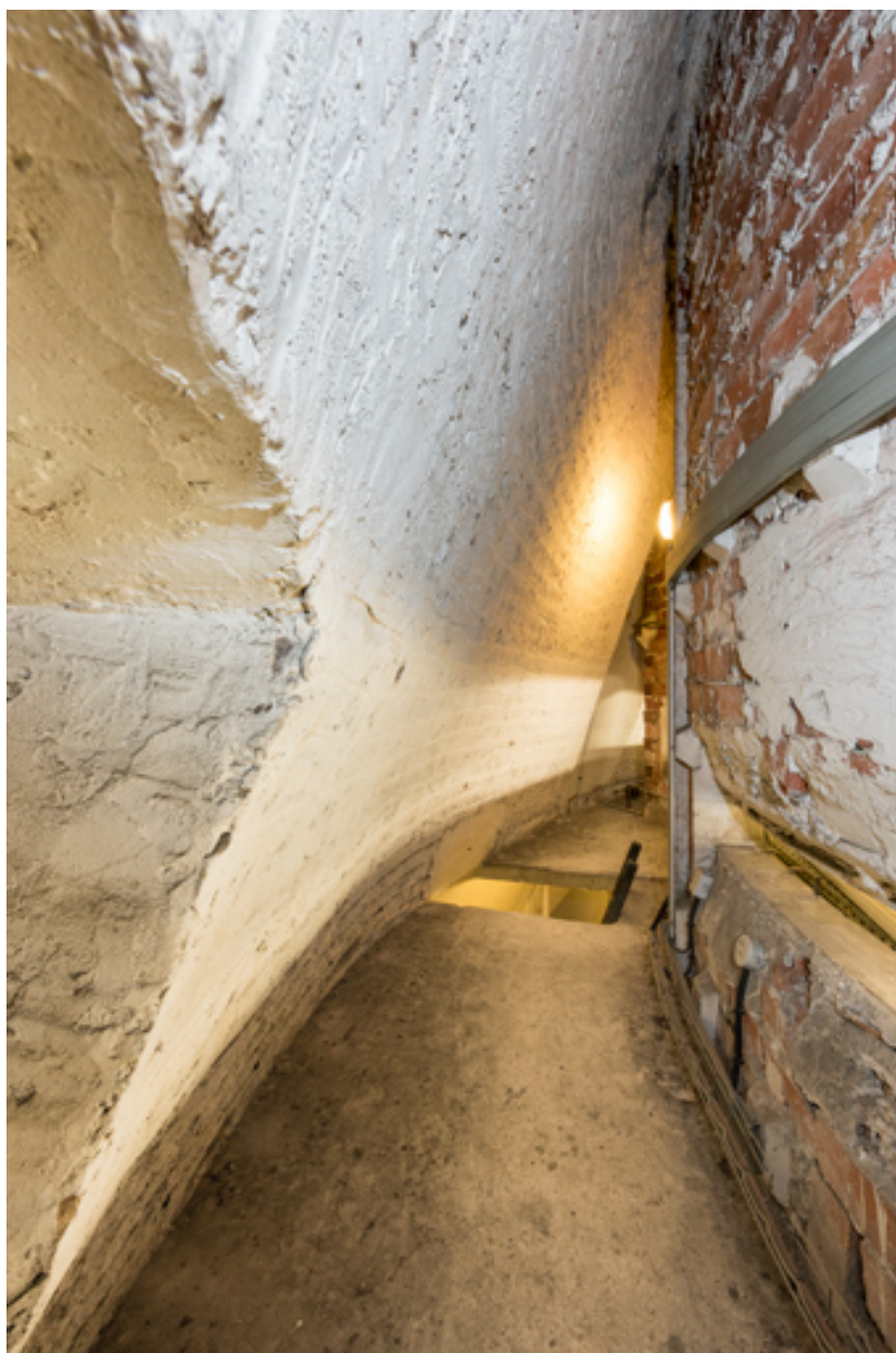
Galerie entre la paroi extérieure (à gauche) et le tambour de la coupole.
