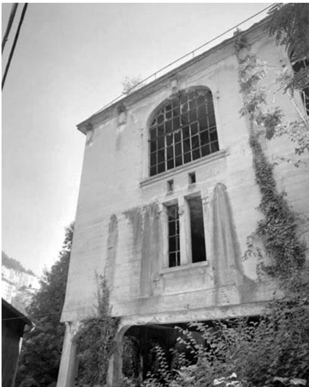
Façade latérale gauche du transformateur : une travée.
