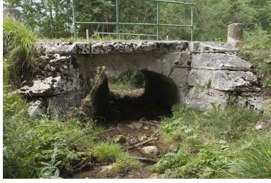
Pont du ruisseau de la Goulette (n° 18), vu depuis l'amont. Phot. Jérôme Mongreville IVR43_20092501619NUC2A
