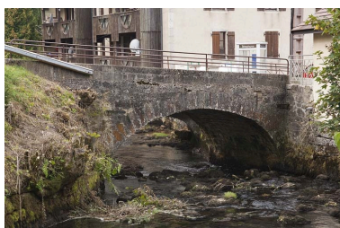
Pont sur la Jougne (n° 13), vu depuis l'amont. Phot. Jérôme Mongreville IVR43_20092501611NUC2A
