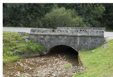
Pont sur la Jougne (n ° 4), vu depuis l'amont. Phot. Jérôme Mongreville IVR43_20092501606NUC2A
