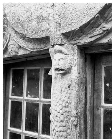
Détail du piédroit des baies au rez-de-chaussée, côté cour. Phot. Yves Sancey IVR43_19772500180X
