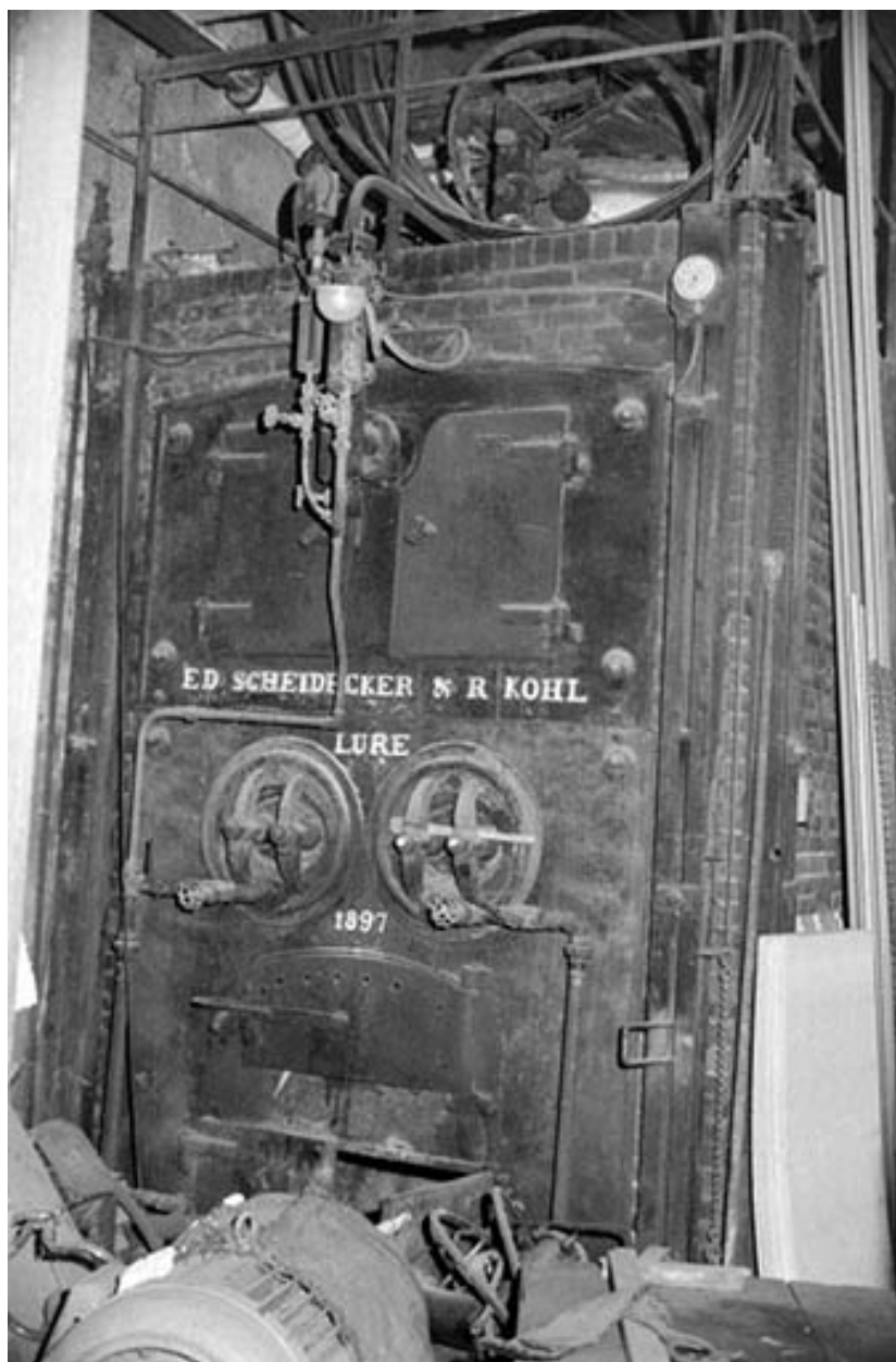
Atelier (C) : chaudière Scheidecker et Kohl.
