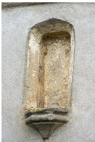
La rue Bontemps : n° 35, détail de la niche ménagée dans la façade. Phot. Jérôme Mongreville IVR43_20217000247NUC4A
